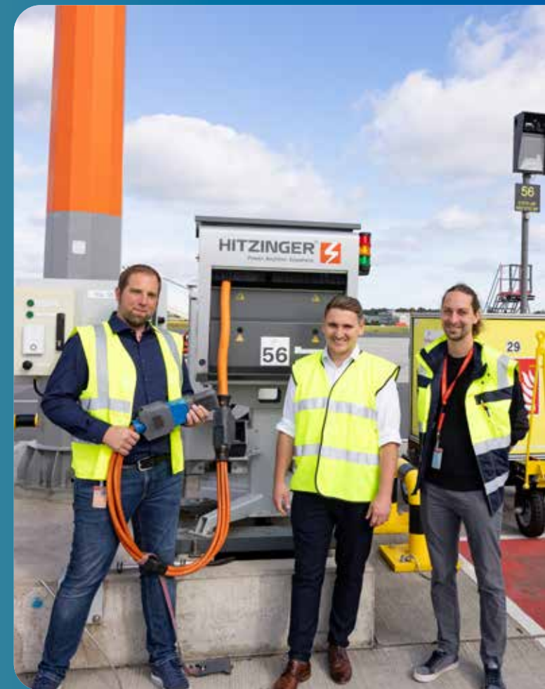
Bodenstromgeräte an Außenpositionen tragen zur Reduktion der CO 2 -Emissionen am Standort bei
